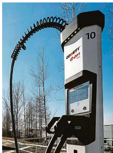
Stojan na dobíjení autobusů.
