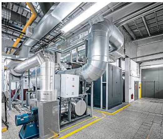
Kogenerační jednotka v kotelně Veolia Energie Praha.
