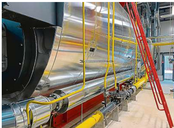
Kotel Tepláren Brno – moderní technologie chrání životní prostředí.
