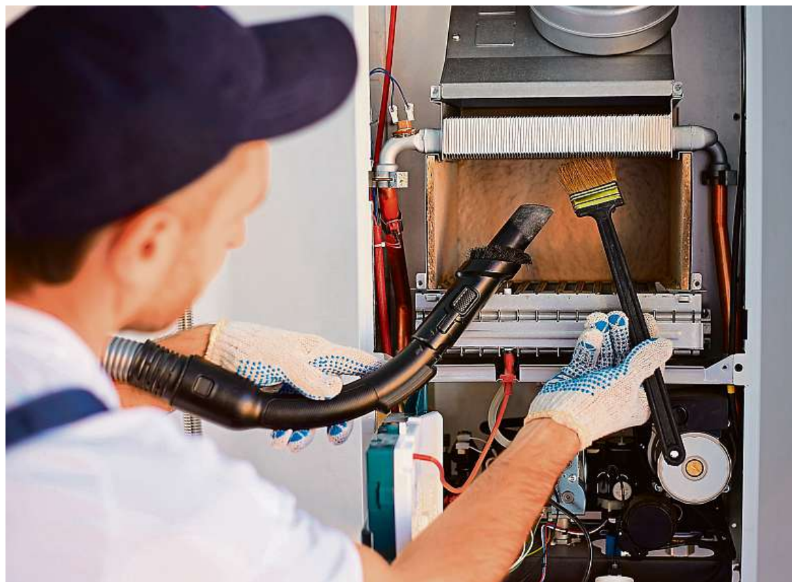
Servis Plynové kotle potřebují pravidelnou údržbu. Bývají v provozu kolem dvou a půl tisíce hodin ročně a jejich účinnost rapidně snižuje například prach, který se usazuje ve výměníku. Foto: Shutterstock
