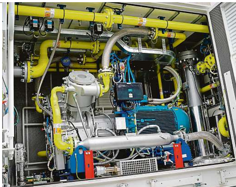
Výkonná sestava kompresoru umožňuje za hodinu přečerpávat až 10 tisíc m³ plynu.
