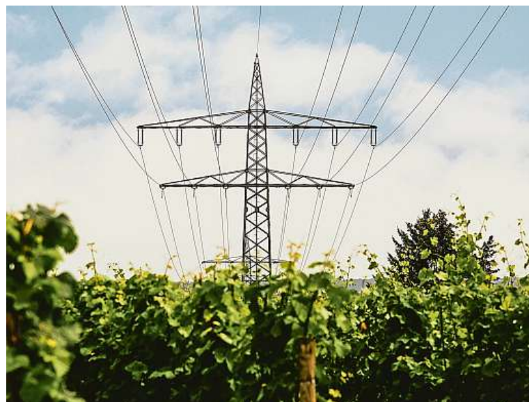
EG.D investuje do modernizace a digitalizace sítě. Staví nové rozvodny, linky, zavádí chytré prvky, které umožní reagovat na toky energií v sítích.
