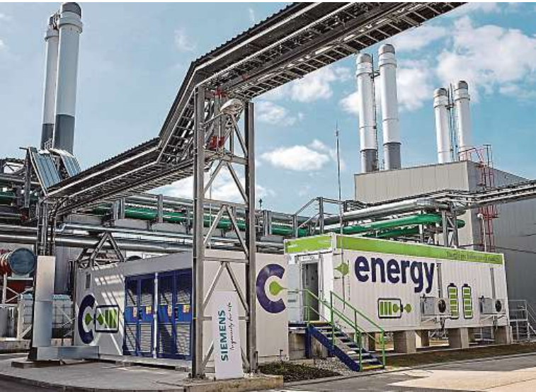
Rolls Royce Kromě jiných zdrojů využívá C-energy při optimalizaci výkonu také šest plynových kogeneračních jednotek Rolls Royce. Svým výkonem i počtem jsou zdaleka největším energetickým zdrojem tohoto typu v České republice.
