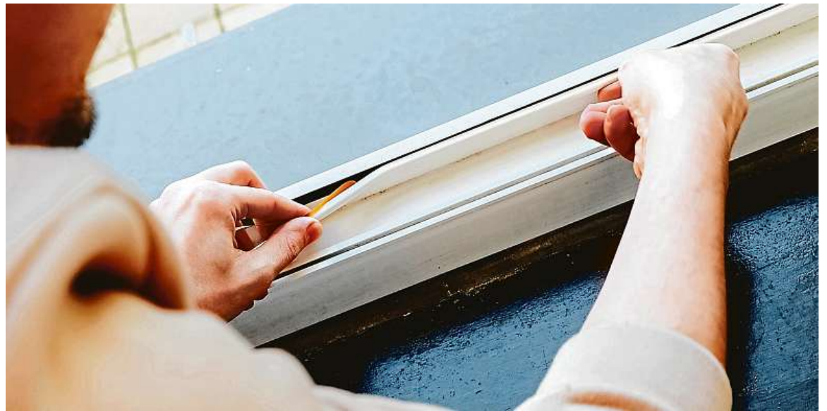
Výměna těsnění Jednou z možností, jak omezit únik tepla, je kontrola a případná výměna těsnění oken a dveří. Nejde přitom o nic finančně náročného. Foto: Shutterstock
